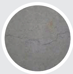
Exemple de fissures
